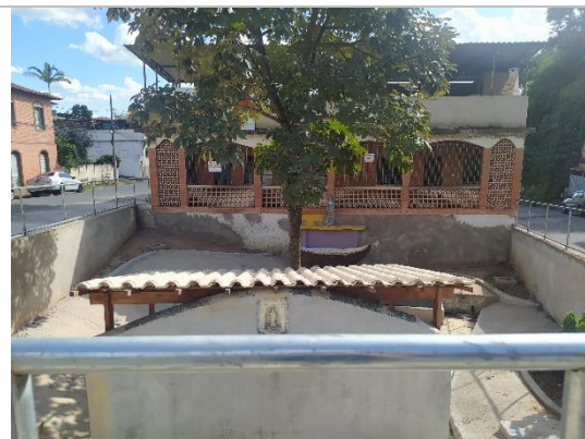
Figura 08: Vista parcial da Fonte, durante processo de reforma Autoria: Tayami F. França - Data: 28/04/2022
