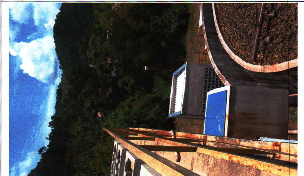
Foto 2: Caixa de distribuição de vazão
