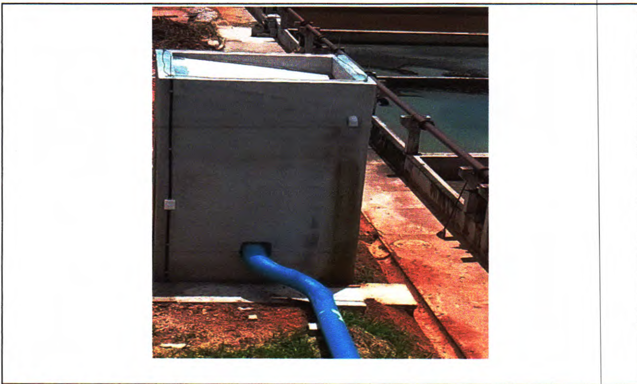
Foto 7: Caso do Exaustor do Filtro
