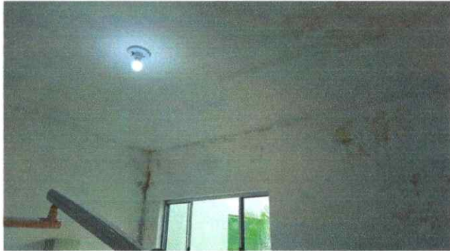
Mofo na parede da Sala de atendimento
