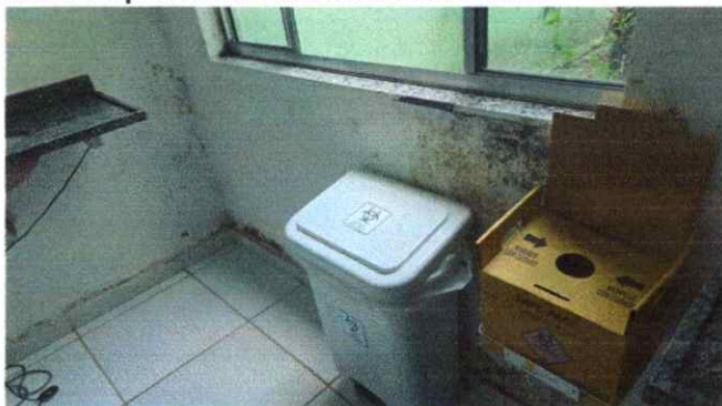
Mofo nas paredes laterais e rodapés
